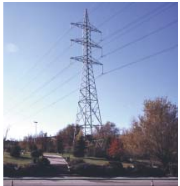
La torre de alta tensión del Parque Botánico será una de las que desaparezcan.
